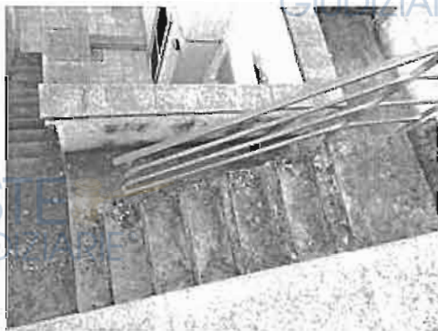
Particolare vista vano scala da cortile interno di accesso al piano primo
