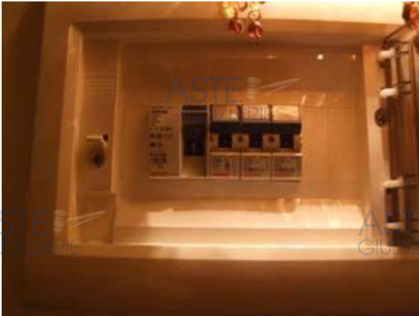
Foto 17: Quadro elettrico generale, con Interruttori differenziali e "messa a terra" (con "Salvavita") a Norma (per la L.46/90 per Sicurezza sugli impianti elettrici). Posto all'ingresso.
