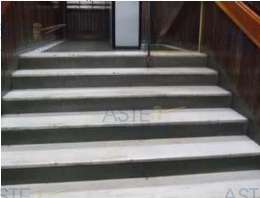
Foto 4: Scala del piano rialzato a quota +65 cm, che porta al vano ascensore, necessita della passerella per disabili o servoscala con pedana (L.13/1989 - sull'abbattimento delle barriere architettoniche).
