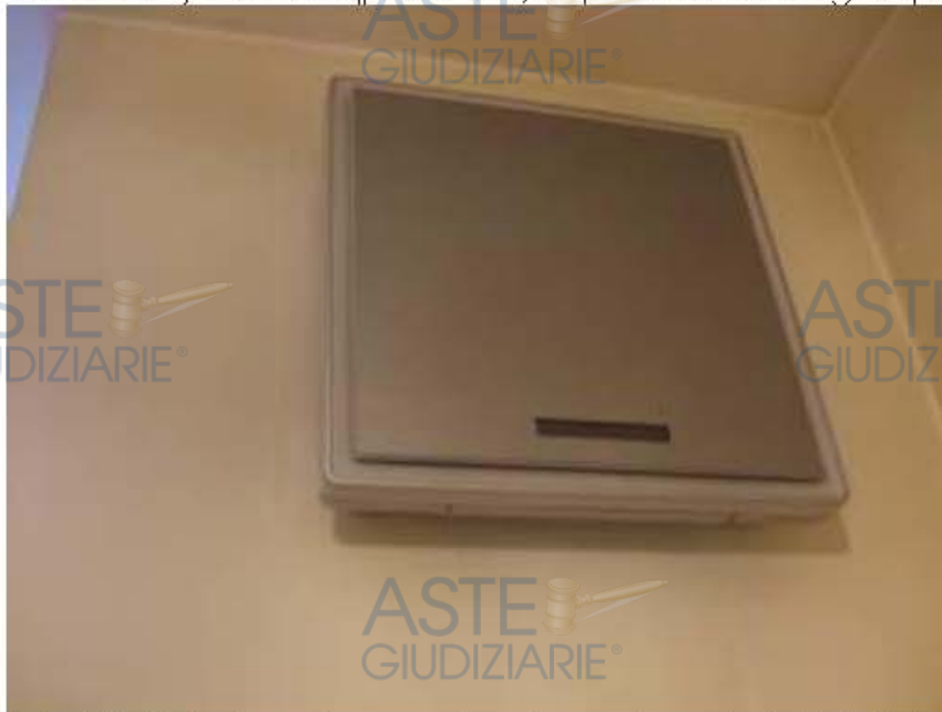
Foto 18: Nella Zona Pranzo - Soggiorno è posto lo "split" del Condizionatore d'aria
