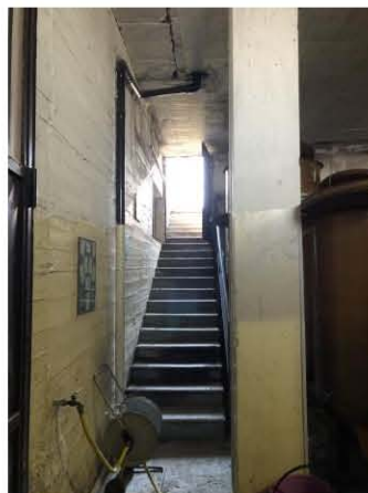
Vista scala di accesso esterna che porta al locale del piano seminterrato costruito in assenza di titolo abilitativo e da fiscalizzare
