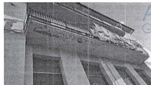
Vista su terrazza danneggiata
