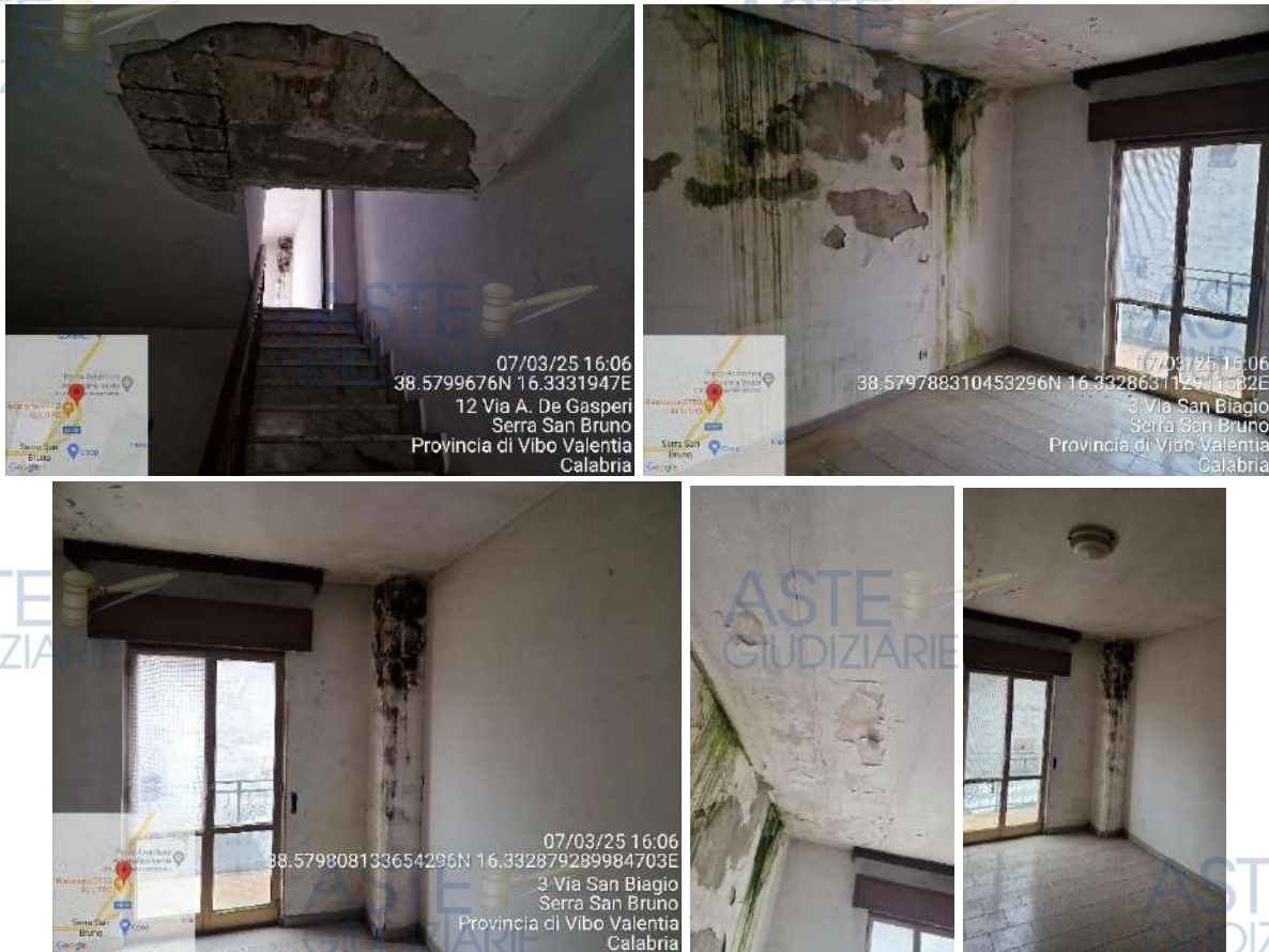
Degradi Via Fiume
