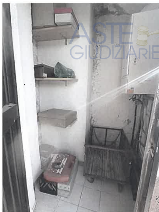
foto n. 20 - veduta vano caldaia
