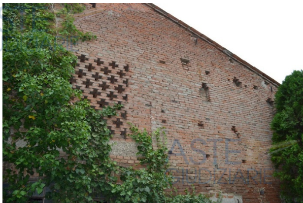
foto 4 - distacchi, nicchie, crepe e riprese nella tessitura del muro ovest, in discreta parte grigliato per aerazione del granaio grande. Notare anche l'interruzione di continuità dell'incordolata visibile in basso a sinistra, segno di organismo edilizio realizzato a più riprese
