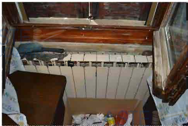
foto 4 - i corpi scaldanti, tutti radiatori in acciaio in cattivo stato di conservazione e tenuti fuori uso risparmiando attraverso l'utilizzo di una stufa a pellet per il riscaldamento, sono sempre fuori traccia, senza nicchie sottodavanzale
