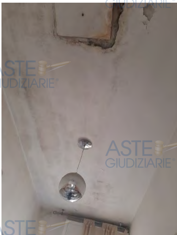
Particolare delle infiltrazioni presenti sui soffitti
