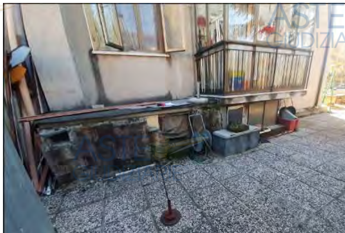
Basso manufatto abusivo a ridosso del fabbricato
