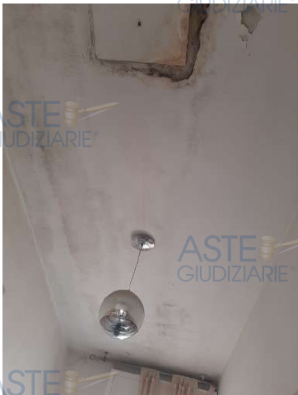
Particolare delle infiltrazioni presenti sui soffitti
