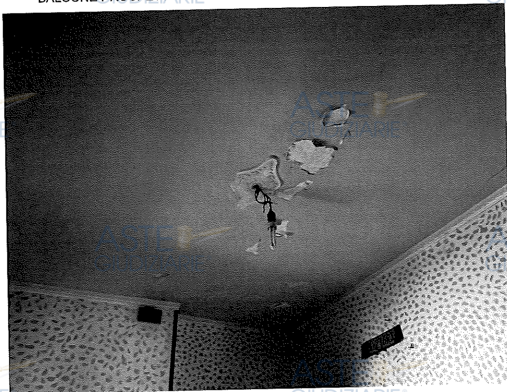
DIFETTI SUPERFICI MURARIE
