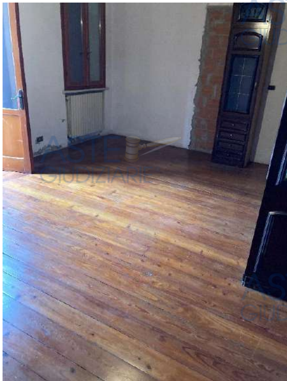
LOCALE NON COMPLETAMENTE RIFINITO P1
