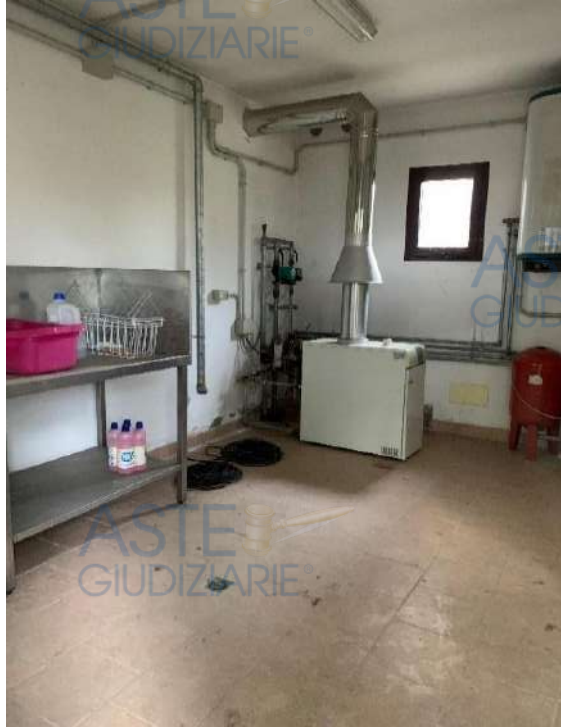
LOCALE CALDAIA SUB.2 CON IMPIANTO IDRAULICO
