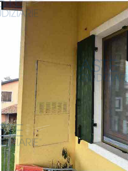
Caldaia in terrazza
