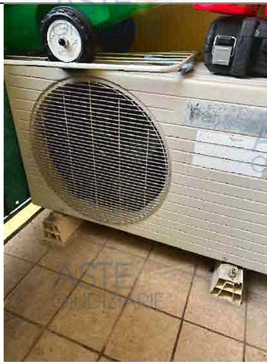
Condizionatore in poggolo
