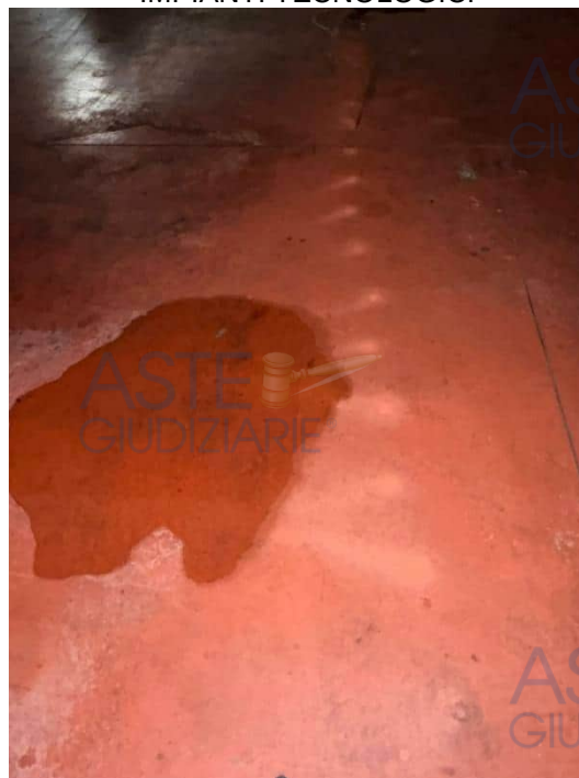
FENOMENO DI RISTAGNO TEMPORANEO DELL'ACQUA DI INFILTRAZIONE DAL TETTO*
