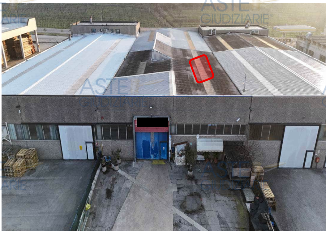
*FOTO AEREA DELLA COPERTURA CON DRONE- NEL RIQUADRO ROSSO LA ZONA DI INFILTRAZIONE RISCONTRATA NEL CORSO DEL SOPRALLUOGO
