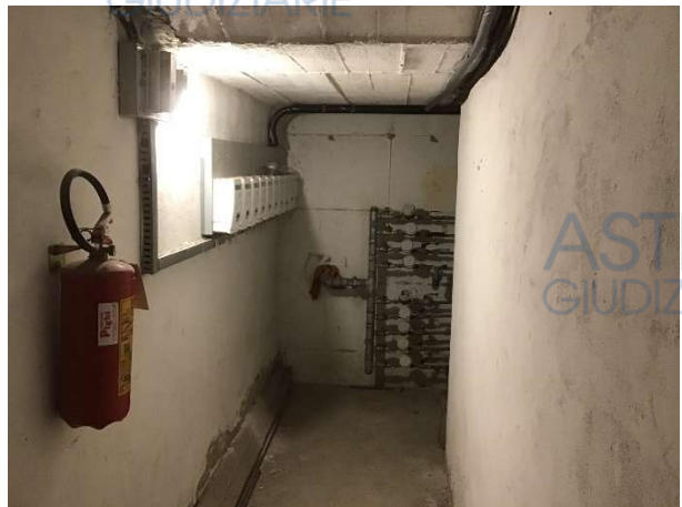
vano contatori condominiale
