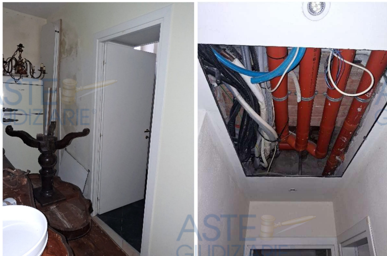
foto 4 – dettagli dei due disimpegni. A sinistra si vede il n. 1, con i problemi di ristagno e trafilamento che affliggono anche quello come tutti i vani contro terra. A destra il n. 2, con evidenza degli impianti termici e idraulici in traccia di plafone
