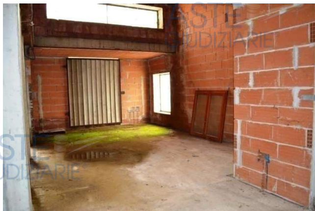
foto 4 - vista interna da ovest della sala al piano terra dell'edificio a destinazione direzionale elevato a due piani f.t. e realizzato al rustico sul m.n. 168 sub 7 nel 2001/2005 con la finestra ad angolo tamponata (visibile a sinistra della foto) e senza la scala a giorno prevista in progetto
