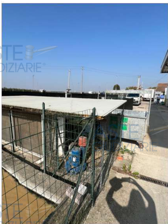
FOTO 9 - Vasche depurazione fronte ovest bene 1.f
