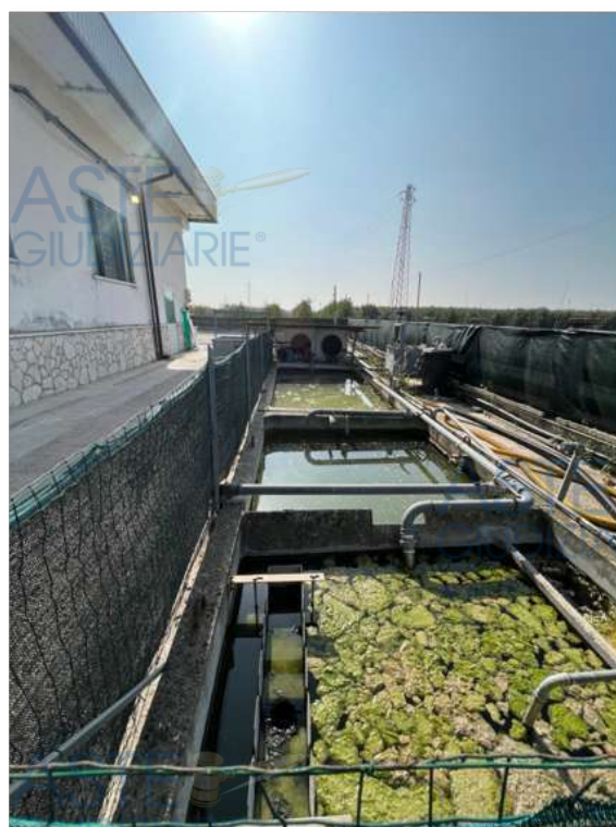
FOTO 10 - Vasche depurazione fronte ovest bene 1.f
