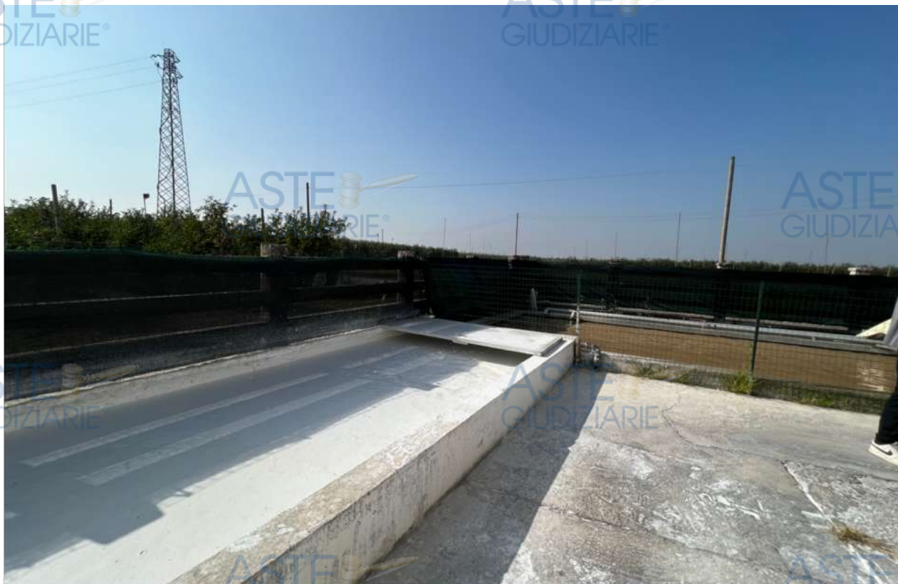
FOTO 8 - Vasche depurazione fronte sud-ovest bene 1.f
