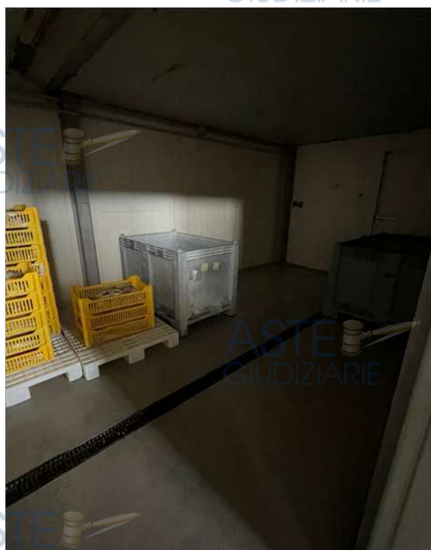
FOTO 25 - Cella frigo 1.a
