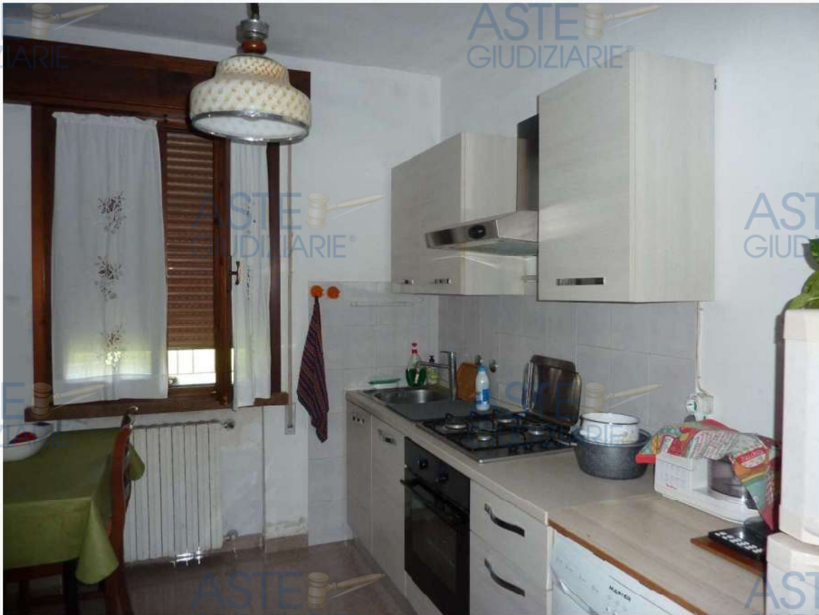
FOTO 7 _ VISTA INTERNA –CENTRALE TERMICA USO CUCINA APPARTAMENTO SUB 5 – PIANO TERRA
