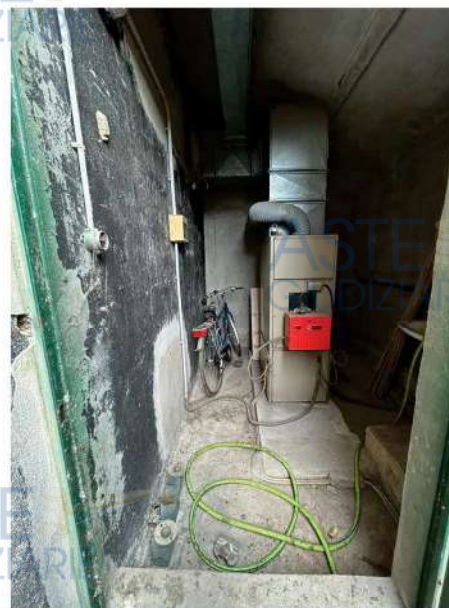
Locale caldaia nel Sub. 10 – B.C.N.C.
