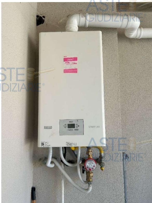
Caldaia a condensazione in terrazza
