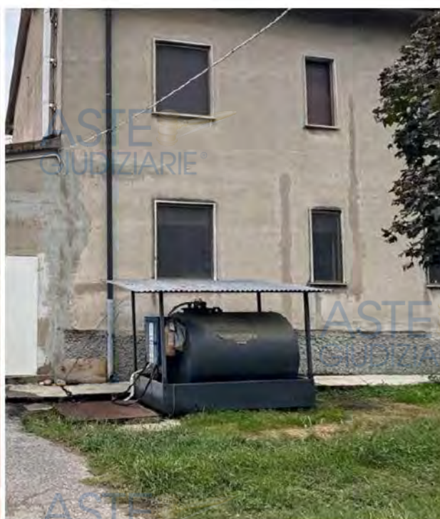
FOTO 7 - Cisterna gasolio comune alle due unità residenziali sita su area esterna sub. 4
