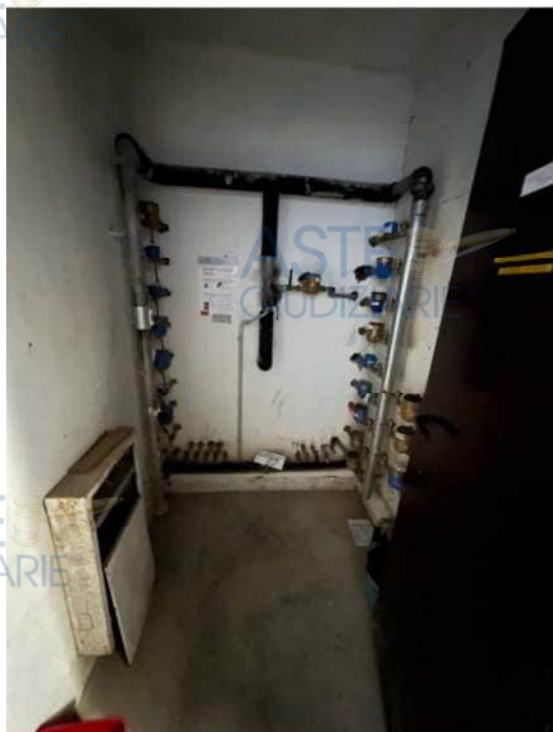
Vista della cantina – locale contatori
