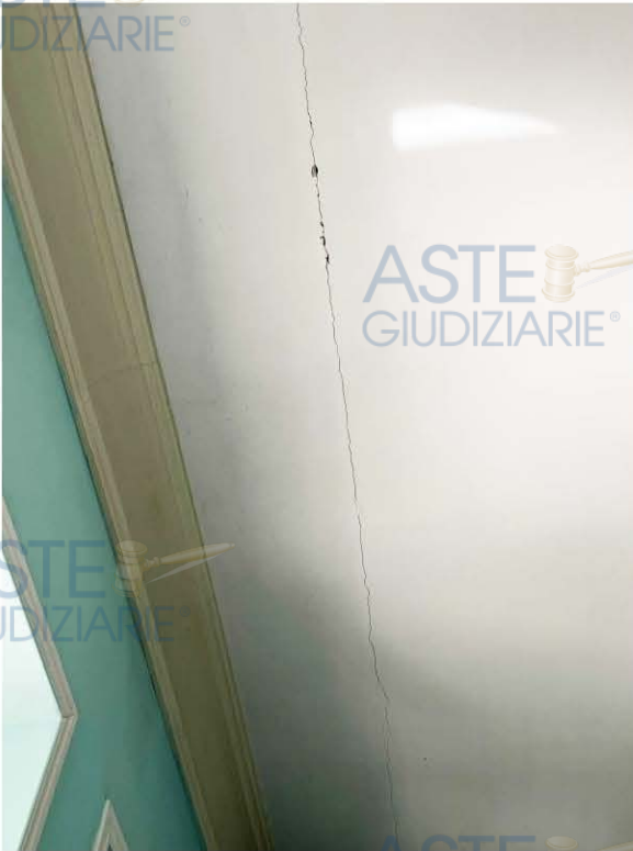
IMMAGINE 7 – LESIONE SOFFITTO
