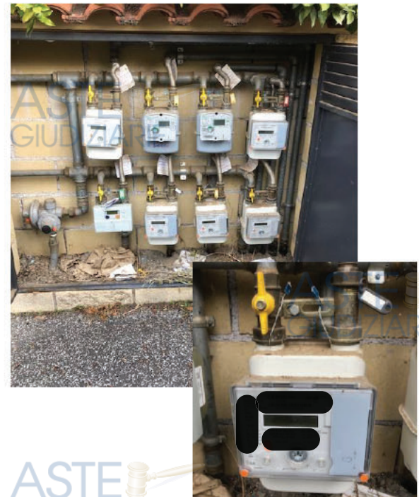
Figura 20_ Vista Contatore GAS
