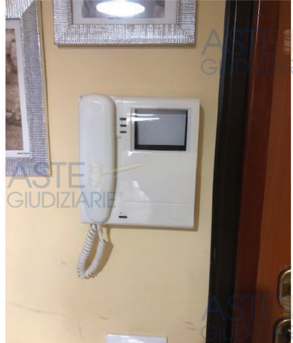
Figura 14_Vista impianto citofonico interno
