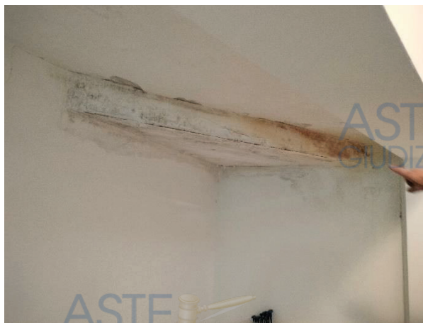
Fenomeni di umidità al piano interrato del sub 53
