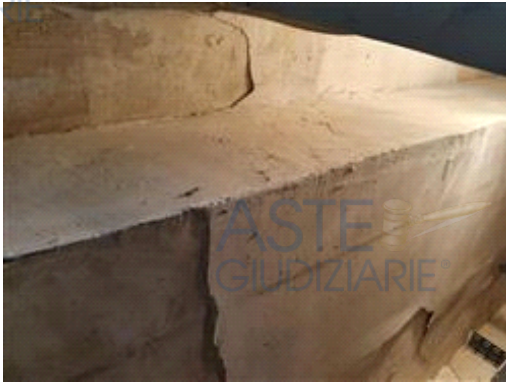
particolare del distacco di intonaco
