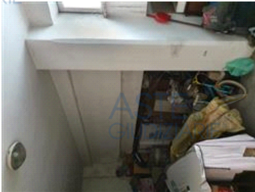
problemi di condensa dell'u.i.u.
