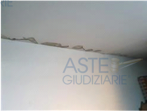
distacco di finitura sul solaio di copertura
