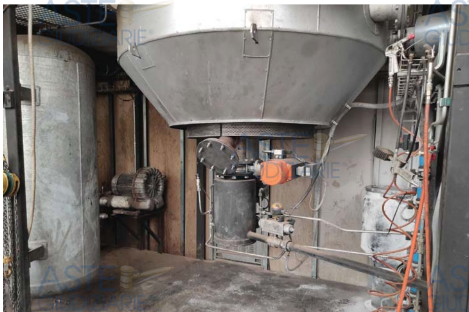
Figura 14 - Vista della zona pulizia Syngas
