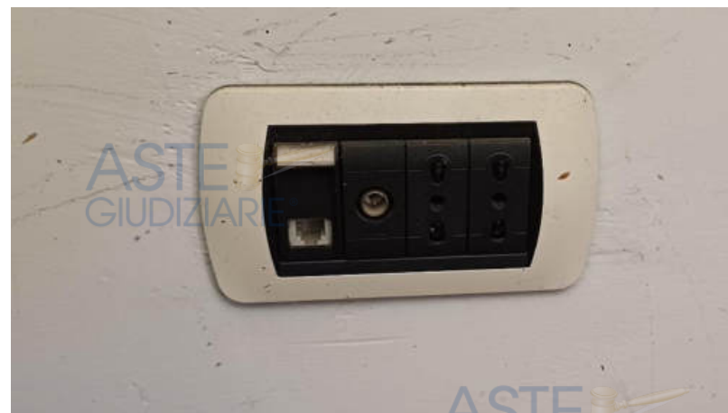
Impianto elettrico-Antenna TV-Rete LAN_09
