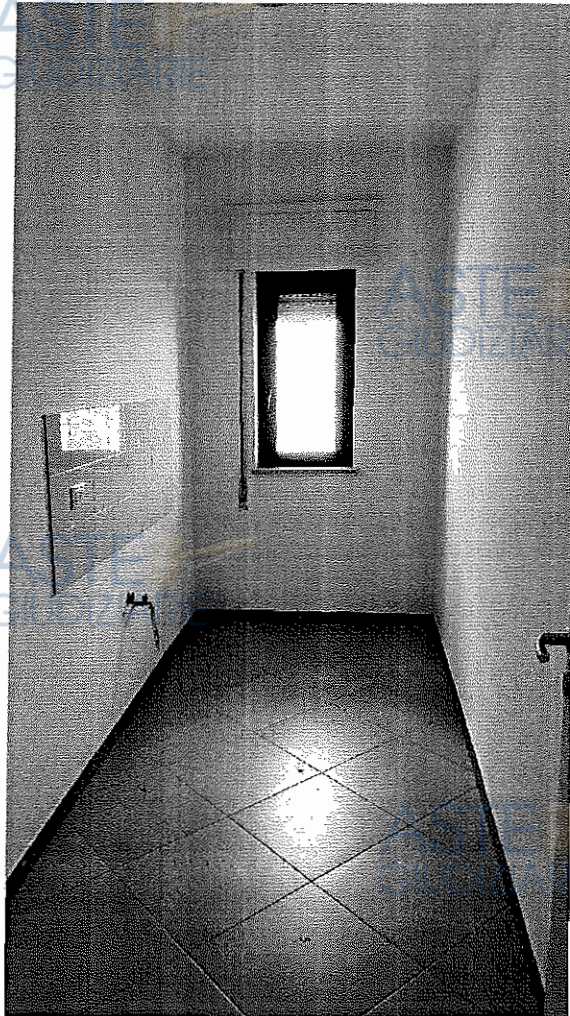
FOTO 6 - LOCALE RIPOSTO SUB. 5
