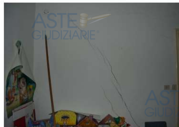
Parete piano terra (degrado)
