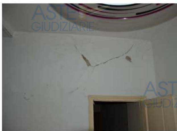
Parete piano terra (degrado)
