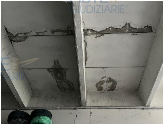
Figura 6 - DANNI DA INFILTRAZIONI
