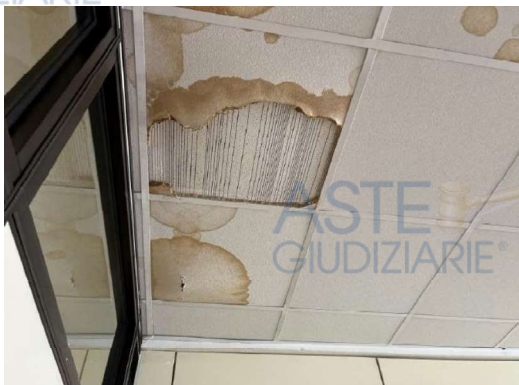
Figura 5 - DETTAGLIO DANNI DA INFILTRAZIONE
