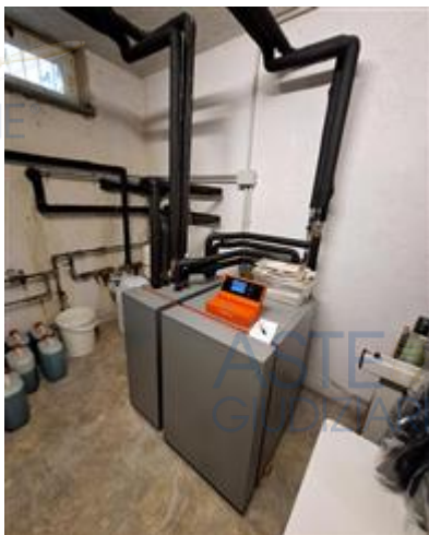
Centrale termica con caldaia Weissman e arrivo sonde geotermiche
