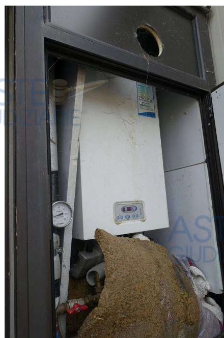
Fig. 25 – La caldaia a gas
