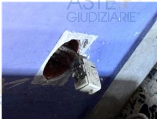
Particolare impianto elettrico
