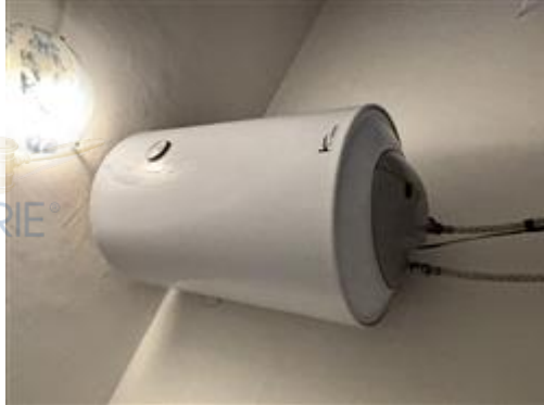
Boiler elettrico posto sopra la vasca da bagno
