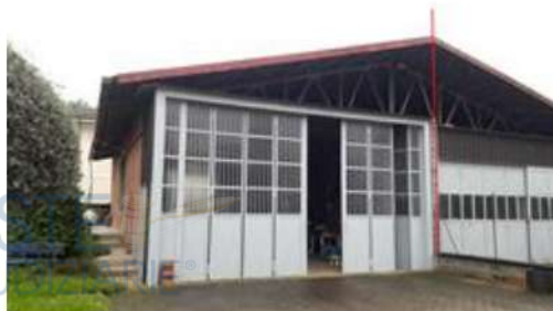
TETTOIA CHIUSA - IN PRIMO PIANO PARTE DIFFORME
