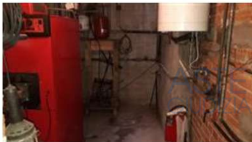
CENTRALE TERMICA NEL LOCALE COMUNE A TERZI
