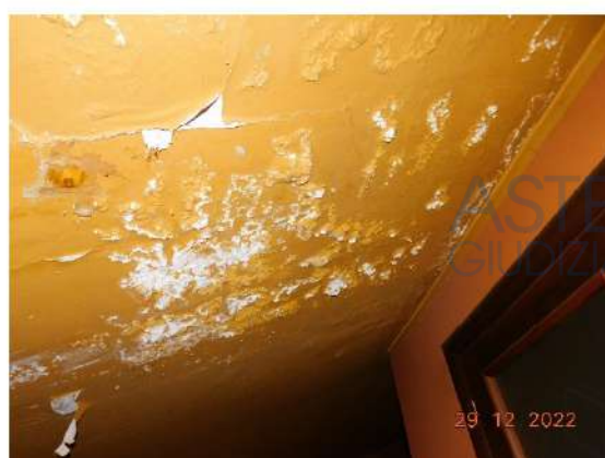
figura - particolare efflorescenze ed ammaloramenti
