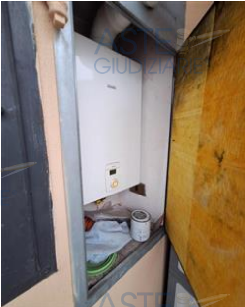
caldaia a gas metano, sul balcone OVEST, per la produzione di acqua calda sanitaria
