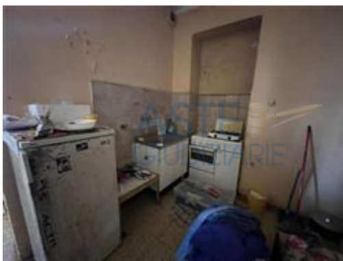
LOCALE UTILIZZATO COME "CUCINA" E AUTORIZZATO COME "ANTIBAGNO"
