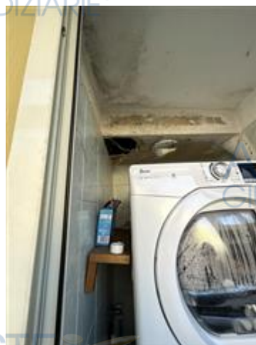
nicchia lavanderia con segni di umidità
