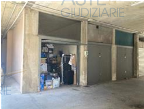
box in oggetto con basculante aperto
