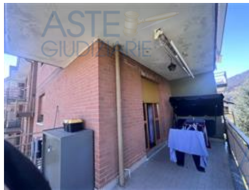
Vista del balcone della camera da letto in cui si apprezzano le macchie ed esfoliazioni della tinteggiatura dovute a verosimili infiltrazioni
