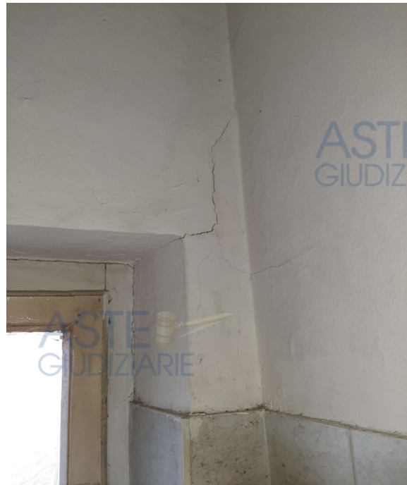
Foto A crepa nel muro del bagno
