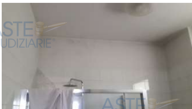
Interno sub 3 bagno p 1 – efflorescenze e muffa
