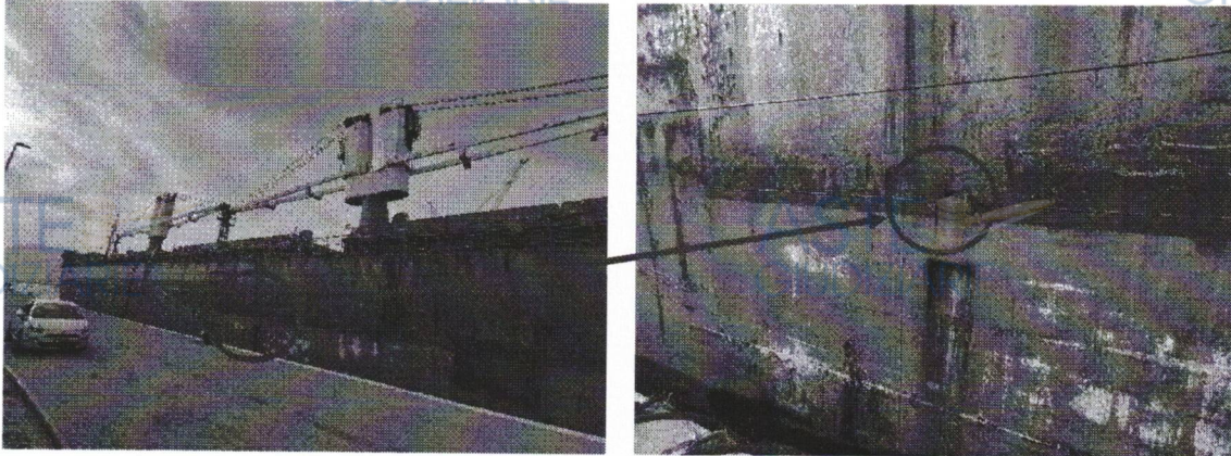
Forature a carico del fasciame lato SN
