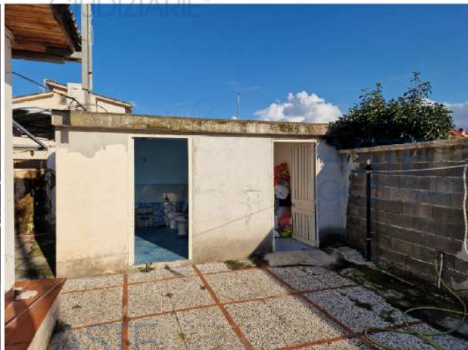
5 | vista del corpo abusivo all'interno della corte
