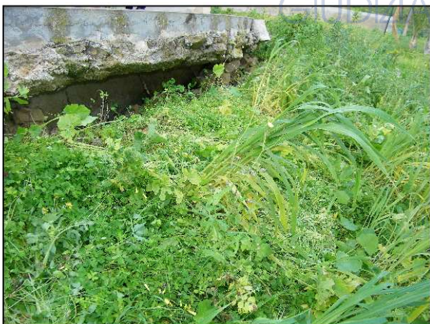
Foto 11. Area del terreno in cui la quota si è abbassata rispetto al basamento del fabbricato
