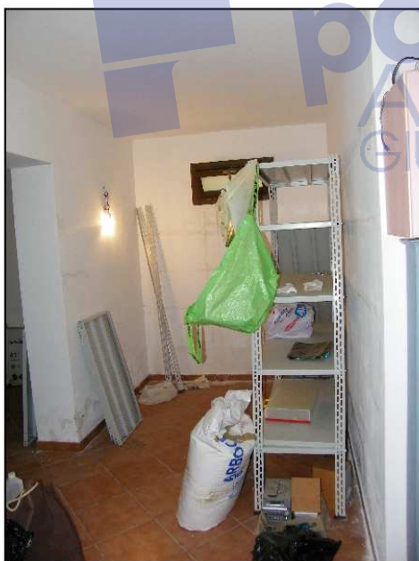
Foto 26. Vano ricavato da ampliamento abusivo
