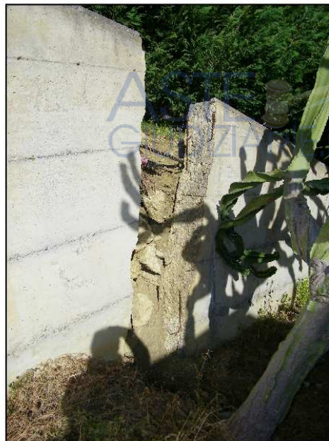
Foto 12. Muro di confine, lesionato ed in parte ceduto
