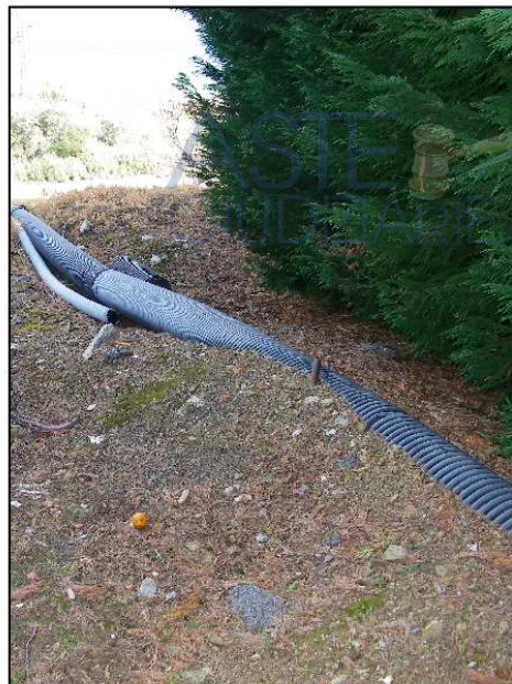
Foto 8. Conduzione di smaltimento delle acque meteoriche portata sopra il livello del terreno a seguito di interventi post frana
