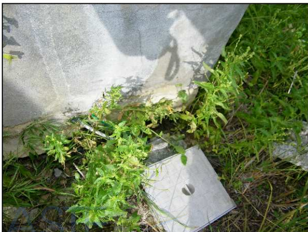
Foto 9. Area del terreno franato sotto il muro di confine
