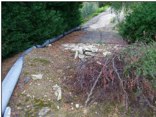
Foto 5. Area alla fine della rampa, prevista a parcheggio, franata
