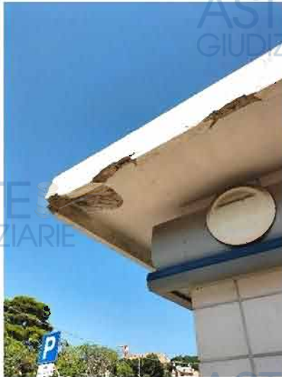
Foto 5 - Stato conservativo del fabbricato
