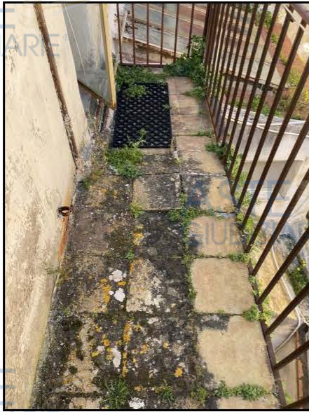
Foto 6 Balcone pericolante per accedere al terrazzino
