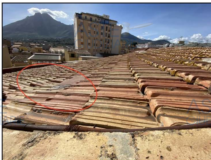
FOTO 3 Tetto a copertura dell'immobile Prossimo al crollo
